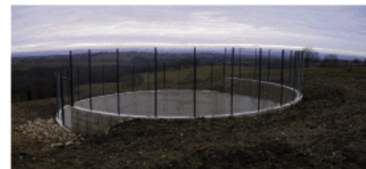
Fosse de stockage 200 m3
